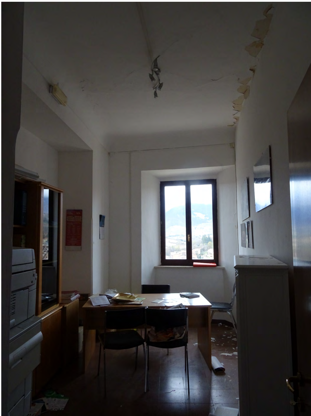
Immagini del piano terra in cui si possono notare le lesioni nei maschi murari e all'intersezione delle murature con i solai di piano
