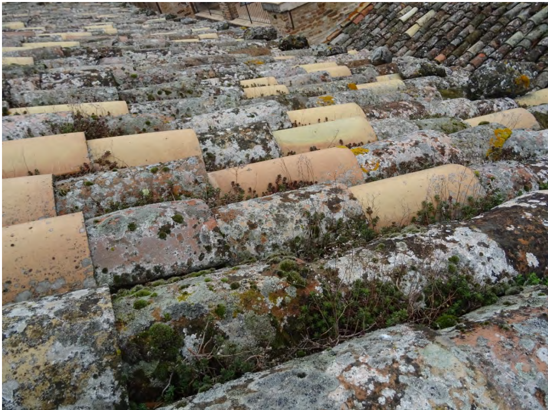
Immagini relative allo stato di conservazione del sottotetto e della copertura con relative prove in situ sullo stato di conservazione delle capriate.
